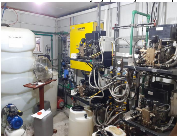
Sl.21. Uutrašnjost objekta-Mašinska hala-oprema za pranje auta
